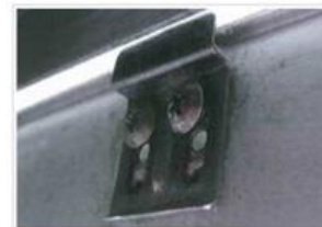
網戸外れ止め金具の破損 網戸が外れやすくなります。
