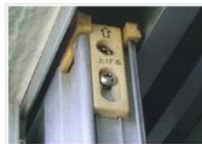
外れ止めの破損 障子が外れやすくなります。
