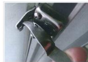
クレセントの破損 防犯上、危険です。
