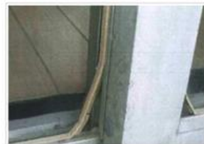
ガラスビートの外れ ガラスの破損、風雨の吹き込みが起
