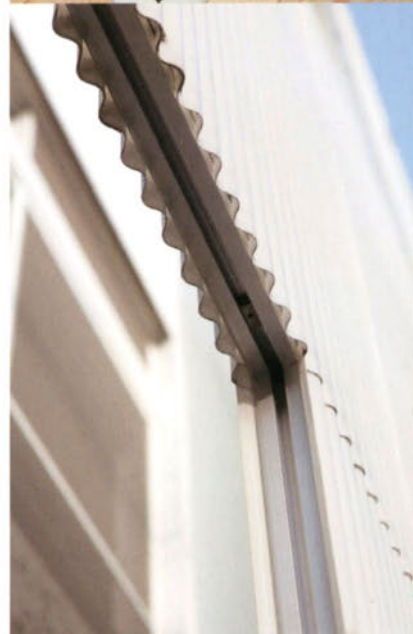
写真上／外階段見上げ。中／2階住居の床。既存の階段を撤去して強化ガラスがはめられた。下／両面にFRPの波板を張ったフレームはアルミ材。
