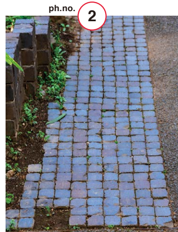
写真上/アスファルトを一部剝がしレンガに置き換えている。下/アスファルトに入れたスリット。
