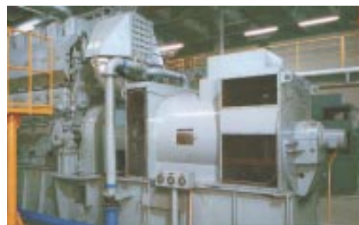
小倉第一工場コージェネレーション設備(上:外観 下:内観)
