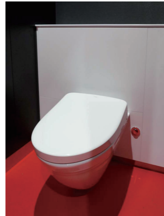
北サイドスタンド 2F女性トイレ 大便器ブース
