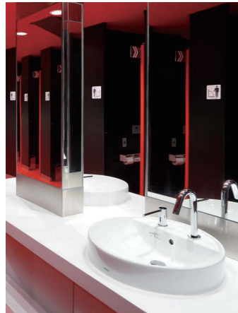
北サイドスタンド 2F女性トイレ 洗面コーナー
