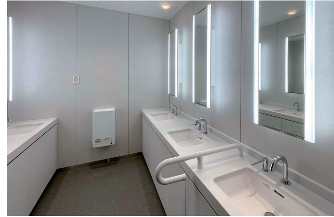
3F 女性トイレ 洗面コーナー
