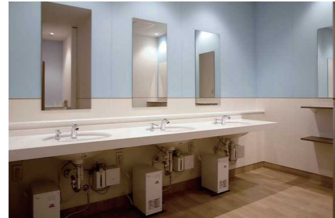
女性トイレ 洗面コーナー
