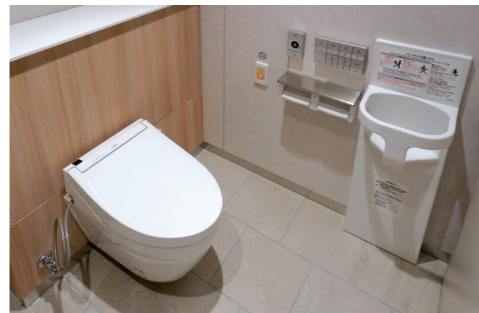
B1北側 男性トイレ 大便器ブース
