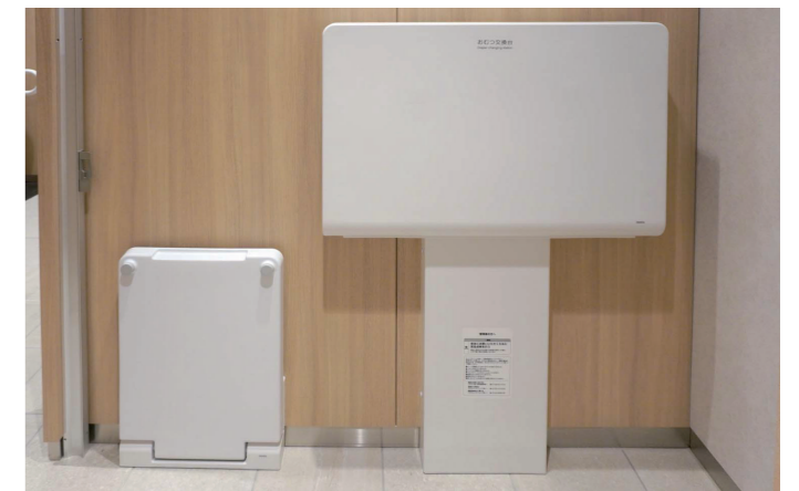
B1北側 男性トイレ 大便器ブース
