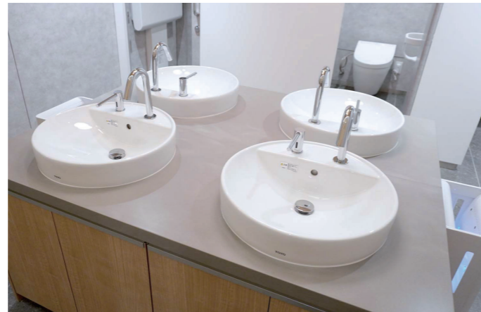
3F北側 女性トイレ 洗面コーナー
