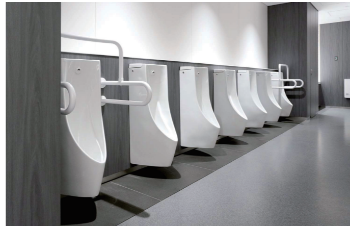
オフィスフロア基準階 男性トイレ 小便器コーナー
