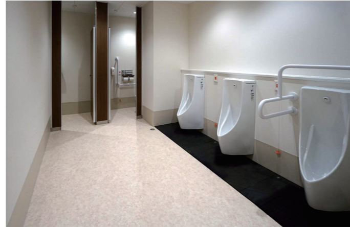
3F病棟階 男性トイレ小便器コーナー
