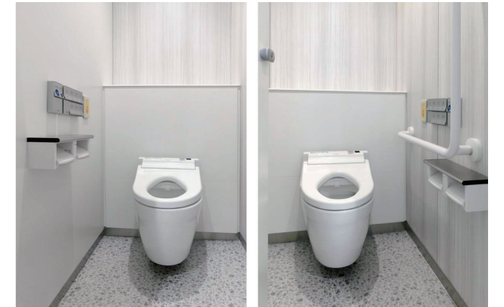
オフィスフロア 基準階 女性トイレ 大便器ブース
