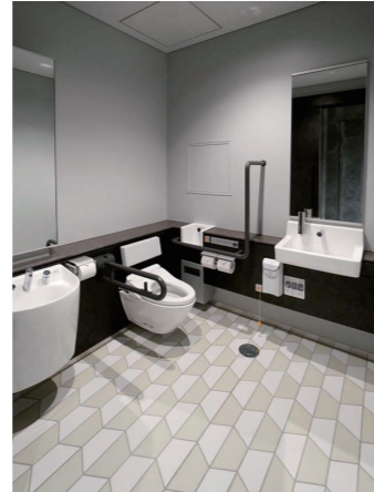
7F多目的トイレ・男女共用トイレ
