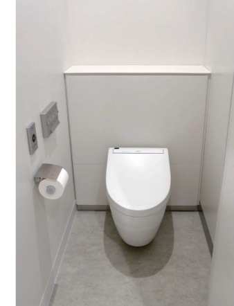
男性トイレ 大便器コーナー
