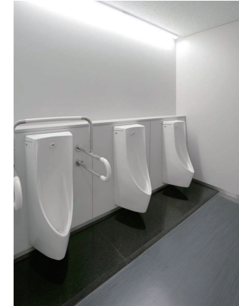
1F南西エリア 男性トイレ 小便器・大便器コーナー
