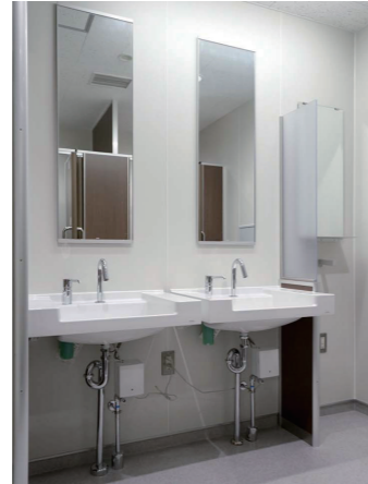
高層棟B1F 女性トイレ
