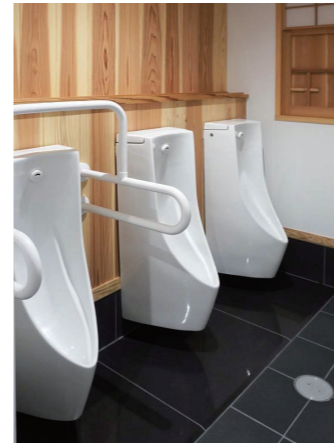
男性トイレ 小便器・大便器コーナー
