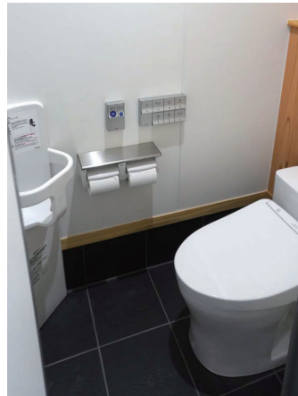
女性トイレ 大便器ブース
