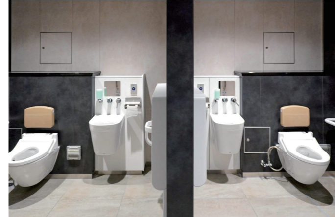
女性トイレ ひろびろブース
