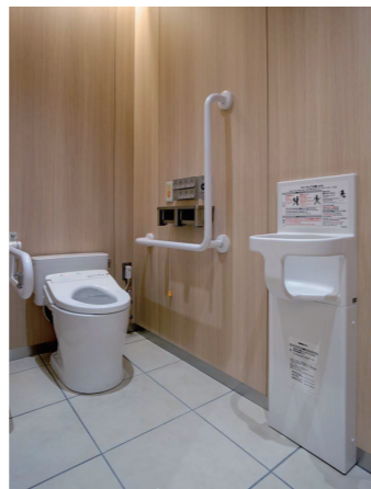
女性トイレ ひろびろブース
