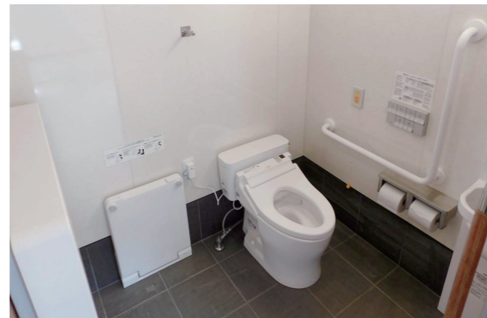
男性トイレ 大便器ブース
