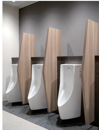
オフィスフロア 4F 男性トイレ 小便器コーナー・ 大便器ブース
