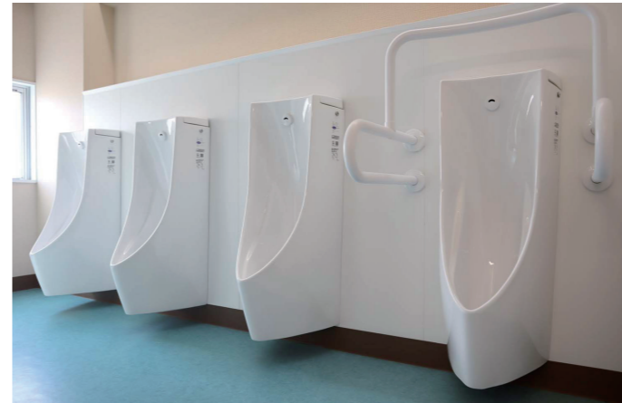
第2サークル棟 男性トイレ 小便器コーナー
