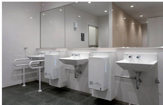
女性トイレ 洗面コーナー
