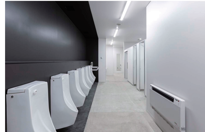
一般トイレ 男性トイレ 小便器コーナー
