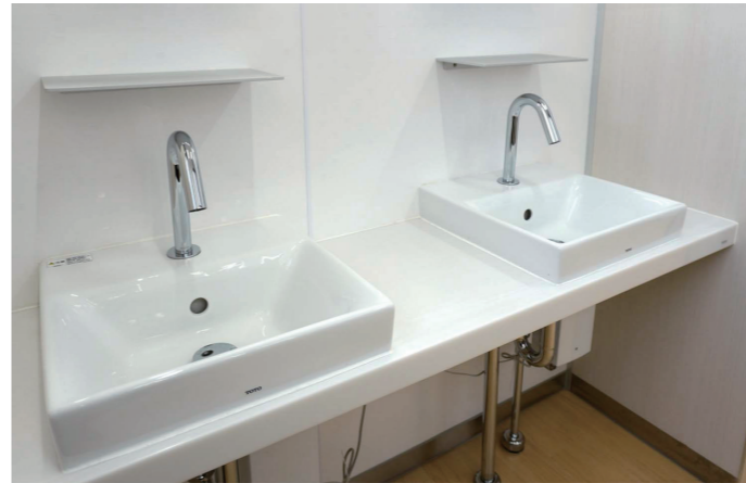
4Fトイレ 洗面コーナー
