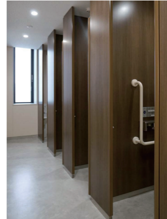
1F東側女性トイレ 大便器ブース
