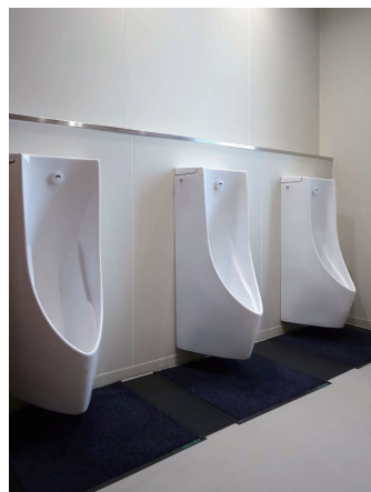
男性トイレ 小便器コーナー・ 大便器ブース
