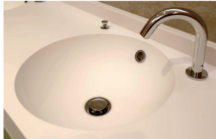
女性トイレ 洗面コーナー
