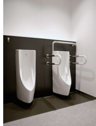
1Fショールーム 男性トイレ 小便器コーナー
