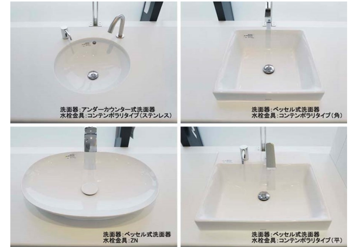
洗面器は、アンダーカウンター式、ペッセル式を設置。丸形と角形を選定した。自動水栓は、洗面器の本体外側に設置するアウトセットタイプと本体上に設置するインセットタイプを採用。
