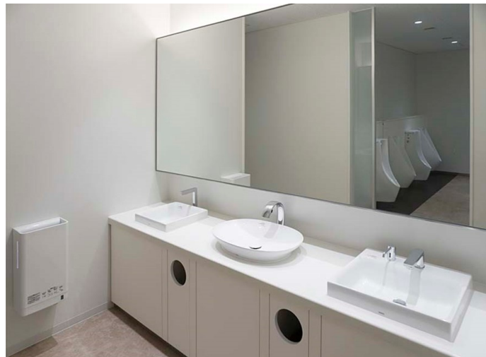
空間を広く見せる全面鏡を設置。女性トイレと同様に4種類の洗面器と水栓金具の設置により、設計者が日々の利用でそれぞれの違いを体感することができる。
