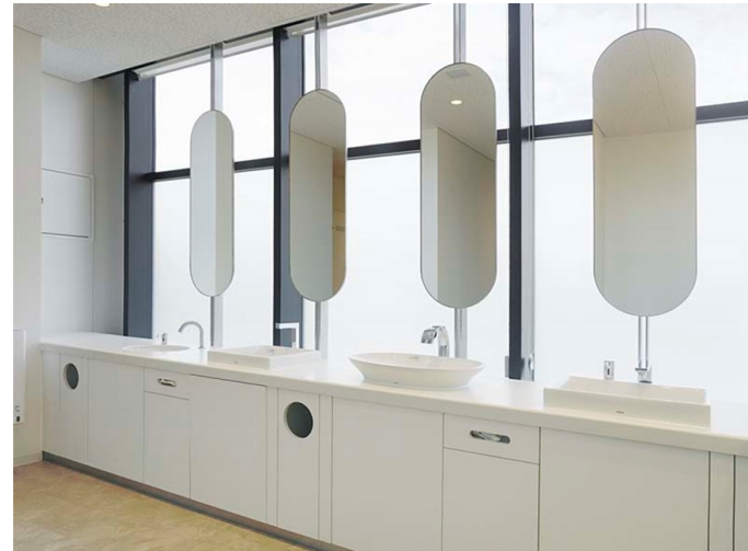
自然光が入る大きな開口部を正面に、洗面コーナーを配置。4種類の洗面器と水栓金具の設置により使用感の違いを体感できる。バリエーションを豊かにすることでショールームの役割を持たせている。
