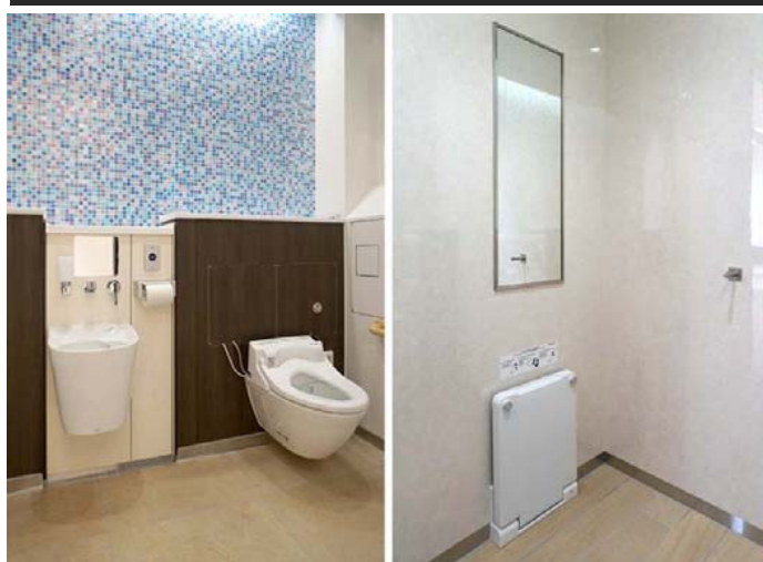
コンパクトオストメイトパックを設置したブースには、衣服を脱ぎ着する際に使用することができるフィッティングボードと荷物フックを設置。
