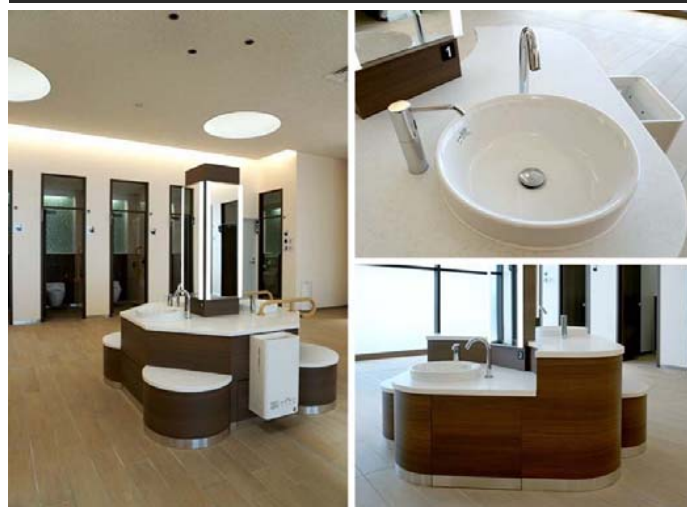
洗面器は、リムの高さを抑えたハーフベッセルタイプを選定。また、一部の洗面器は、小さなお子さまが利用しやすいように低く設置している。
