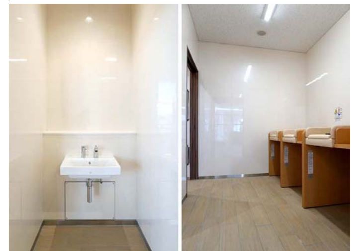
ベビーコーナーの入口脇には壁掛洗面器を設置し、おむつ交換の際に手を洗うことができるように配慮している。おむつ替え台コーナーの奥には、個室タイプの授乳室を設けている。
