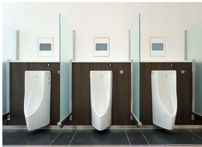
小便器は、清掃性のよい壁掛式小便器を設置。利用者のプライバシーに配慮し、小便器の間に間仕切りを設けている。
