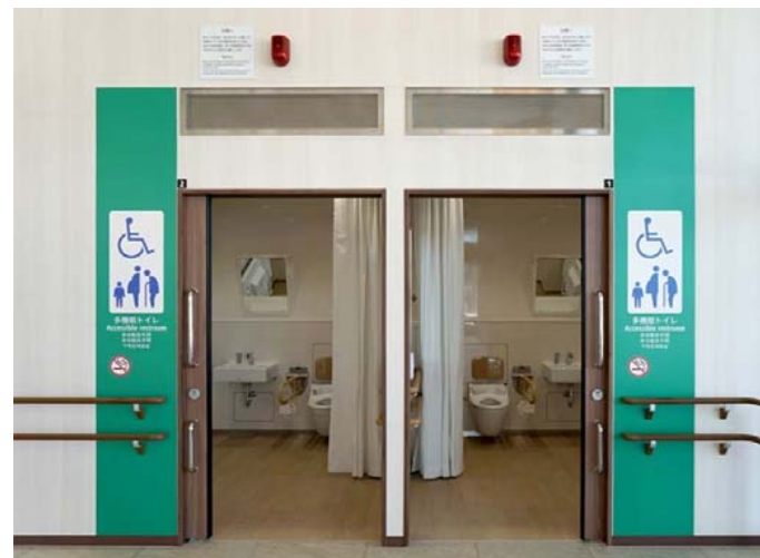
車いす使用者や大型ベッド使用者の使用を優先した多機能トイレ。同じ仕様のトイレを左右勝手違いで設置。介助が必要な利用者のプライバシーに配慮して、ブース内にカーテンを設置している。
