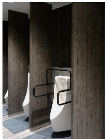
2F共用部 男性トイレ 小便器コーナー
