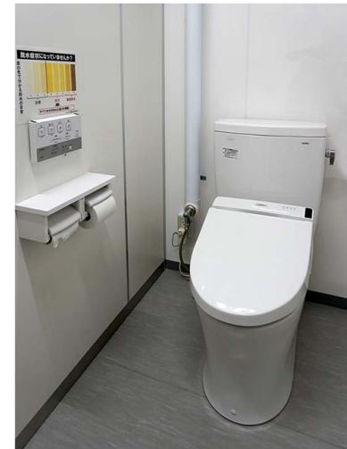
女性社員より要望の高かった擬音装置を設置。棚付き紙巻器を用い小物が置きやすい配慮も追加している。
