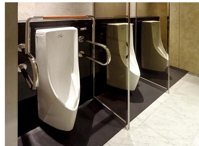
新尿石抑制・節水システムを搭載した自動洗浄小便器を採用。足元には防汚・防臭機能を備えたハイドロセラ・フロアを採用。
