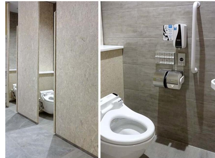
女性トイレ同様に、男性トイレにも、すべての大便器ブースに手すり、ベビーチェアを設置している。
