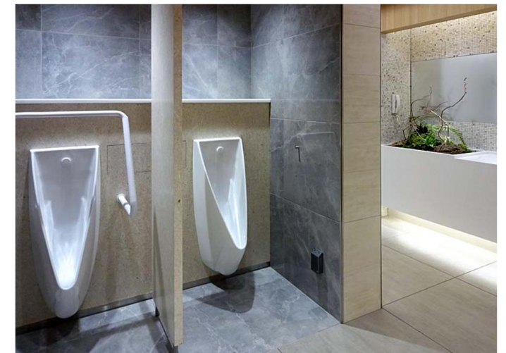
小便器は、スタイリッシュな空間にふさわしく、デザイン性と機能性に優れたRESTROOM ITEM 01を採用。上質感の演出とともに、プライバシーに配慮して、小便器の間に間仕切りを設置している。
