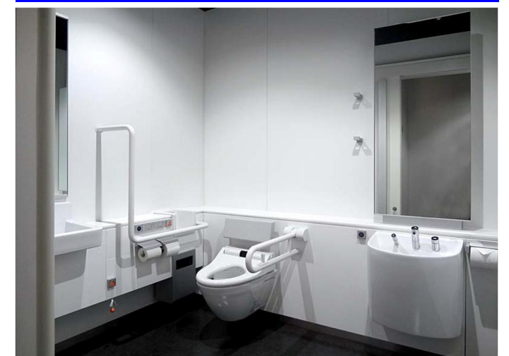
男女トイレの入口横に多機能トイレを各1ヶ所設置。オストメイトの方に配慮して、オストメイト対応マルチパックを備えている。
