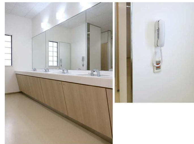
洗面カウンターにアプローチしやすいように、洗面カウンターのフロントパネルを斜めに設置。洗面コーナー横の壁に、トイレ内の緊急時対応用として呼出ボタンとインターホンを設置している。
