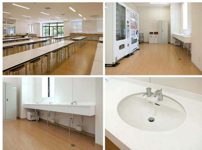
ランチルーム内の洗面コーナー。衛生性に配慮、ノンタッチで水の出し止めができる自動水栓を設置。電気温水器を備えているため冬場はお湯で手洗いができる。
