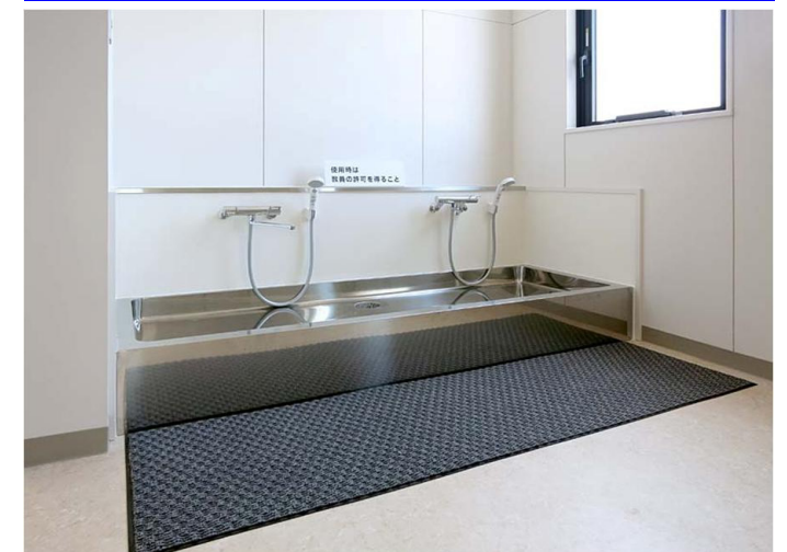
スポーツ後のケアのために、体育館入口付近に足洗い場を設置。シャワー金具は、シャワーヘッドの手元のボタンで吐水・止水ができる、節水性と利便性の高いクリックシャワーを採用している。
