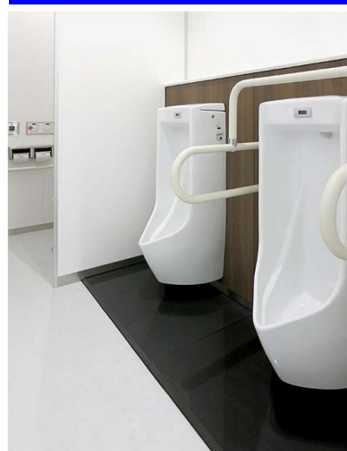
小便器の足元には、尿の飛散によるにおいや汚れを軽減する、ハイドロセラ・フロアPUを設置。
