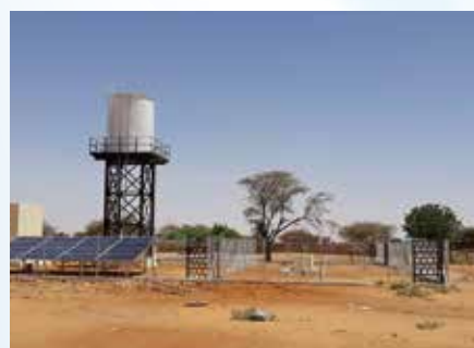
完成した給水施設
