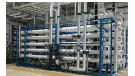
東陶（遼寧）有限公司：RO水処理装置
